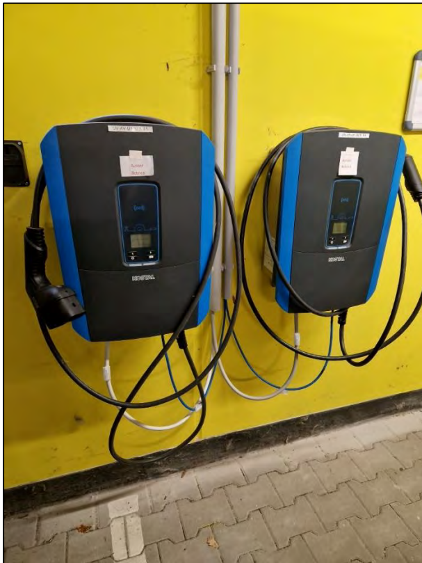
Abbildung 100: Zwei der fünf installierten Wallboxen in der Tiefgarage Regensburg im Installationszeitraum.
