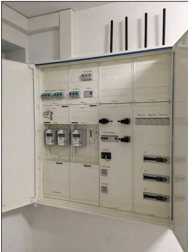
Abbildung 55: BDL-Innenmessschrank. Umsetzung des im Projekt erarbeiteten Mess- und Zählerkonzepts für den Pilotbetrieb.
